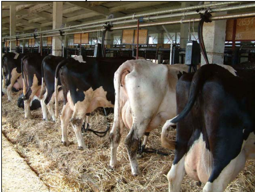
Sl. 4. Muzne jedinice, mlekovod i vakuum vod.
